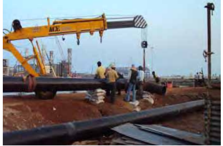
गुजरात स्टेट पेट्रोलियम कार्पोरेशन लि. के लिए मल्लावरम में रॉ वाटर की पाइपलाइन परियोजना
